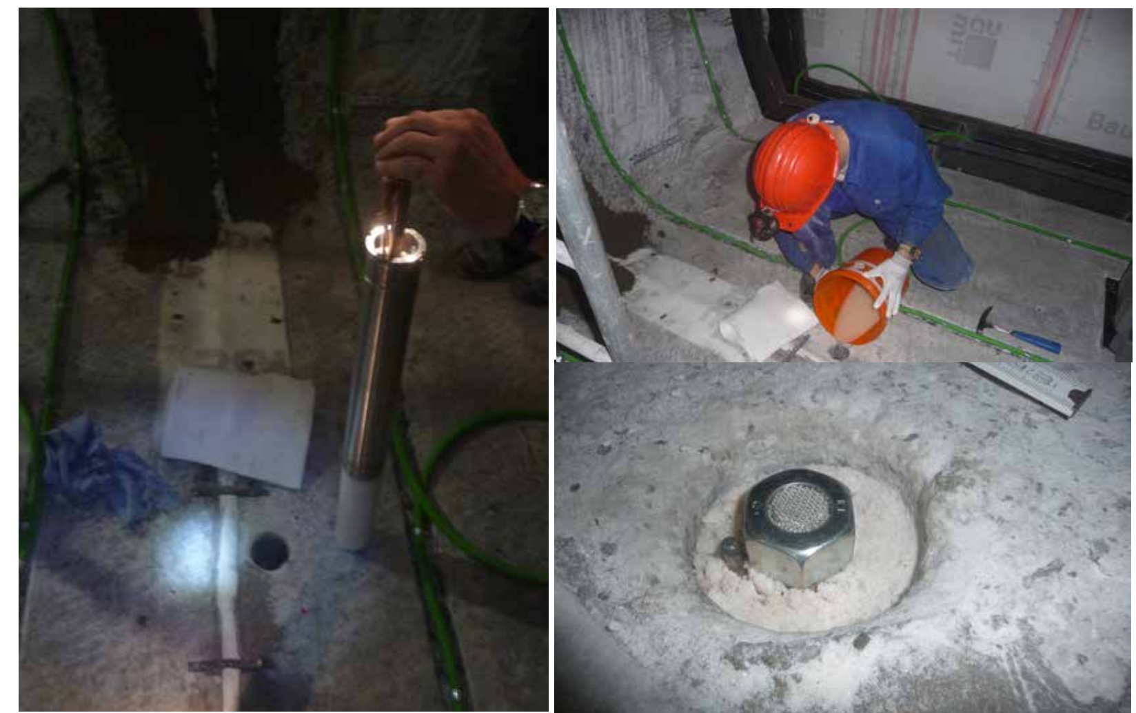
Abb. 1: Einbau eines batterieversorgten Funksensors in ein Abdichtbauwerk unter Tage
