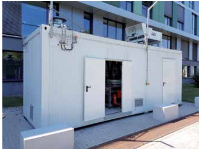
Abb. 2: Fotografie der Hochdruck-Elektrolyse-Testanlage im industriellen Maßstab. In einem integrierten Druckbehälter können neuartige Elektrolyseur-Stacks bis zu einem Wasserstoffproduktionsdruck von 100 bar experimentell untersucht werden.
